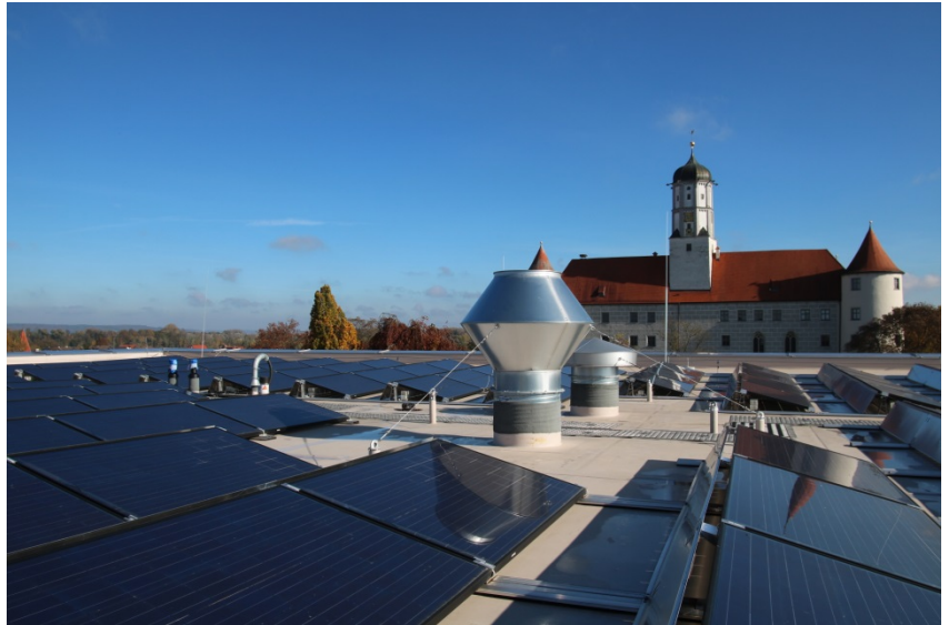
Photovoltaikanlage mit Schloss Höchstädt (© Bauamt Krumbach)
