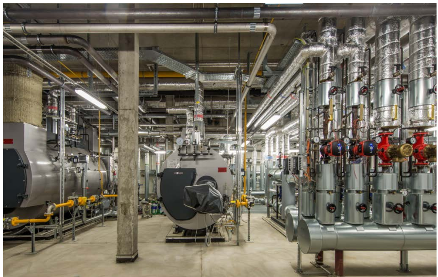
Strom- und Wärmeerzeugungsanlage (© Prof. Dieter Leistner)
